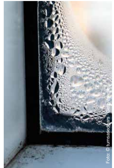
Schimmelpilz-Bildung und andere Feuchteschäden können die Bausubstanz schwer schädigen und sind gesundheitsgefährdend.
